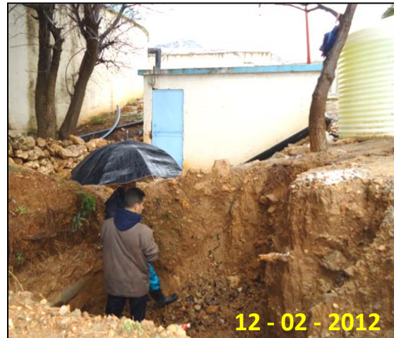
Photo 3-12 : Accès au compteur (Réservoir Mansourah ...).
