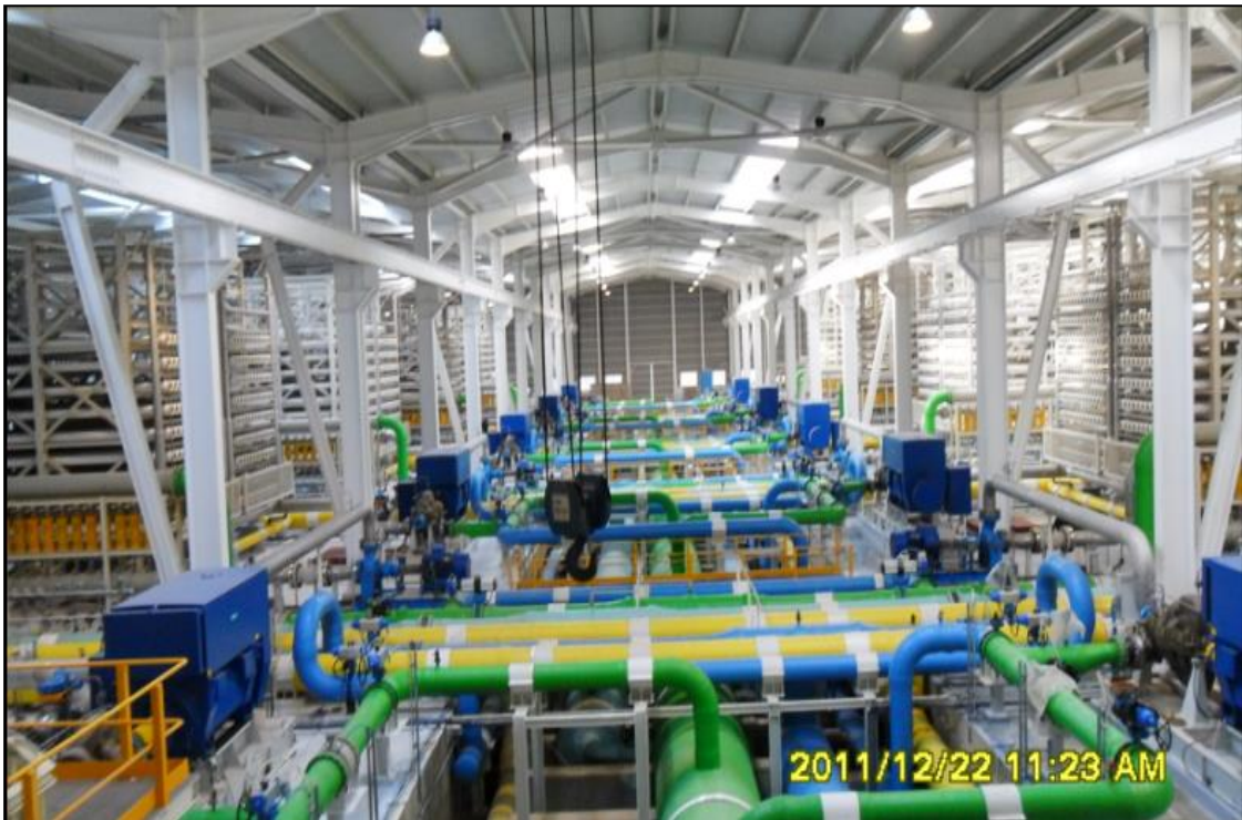
Photo 3-5 : Station de dessalement d'eau de mer de Honaine.
