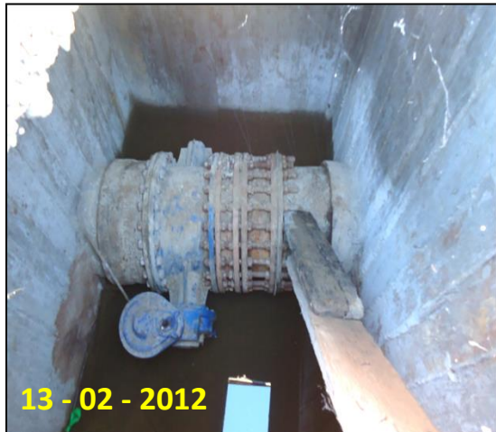
Photo3-11 : Conduite principale de la chaîne de Béni Mester.
