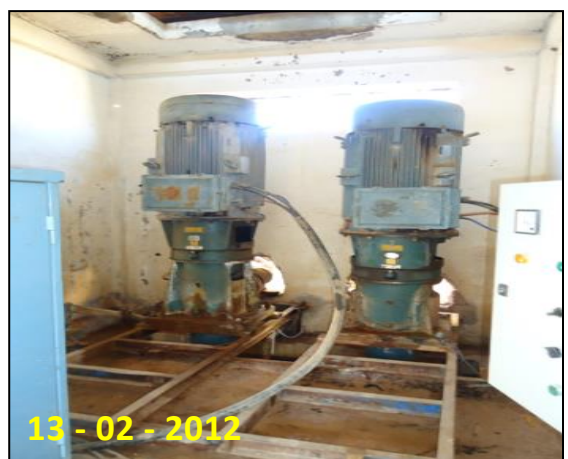
Photo 3-8 : Stations de pompage SP Boudjmil.
