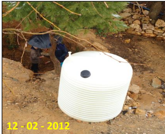
Photo 3-2 : Petite citerne de préparation du chlore (utilisé au niveau des réservoirs Mansourah).
