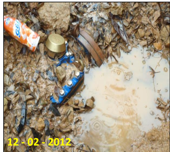
Photo 3-13 : Compteur du réservoir Mansourah ...
