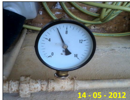
Photo 3-17 : Mesure de la pression au niveau des 120 Log.
