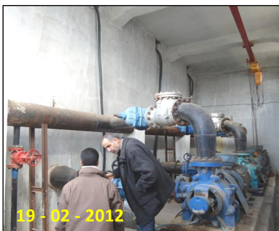
Photo 3-7 : Stations de pompage SP3 de Béni Boublène.
