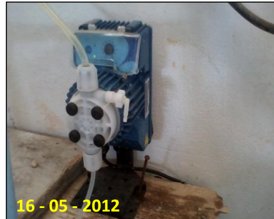
Photo 3-3 : Pompe doseuse pour introduire le chlore dans le réservoir de Mansourah 3 (5000 m 3 ).
