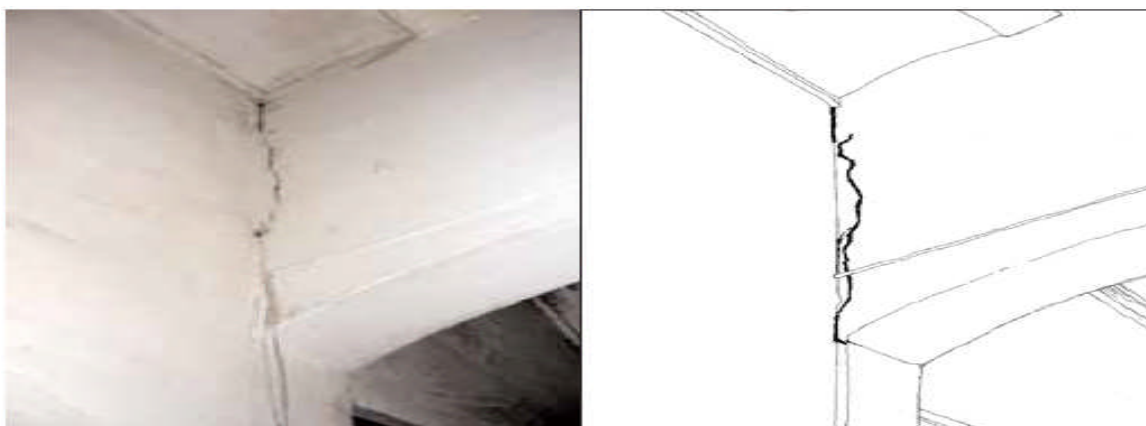
Figure 1.17 : Fissure dues à des différences de charges
