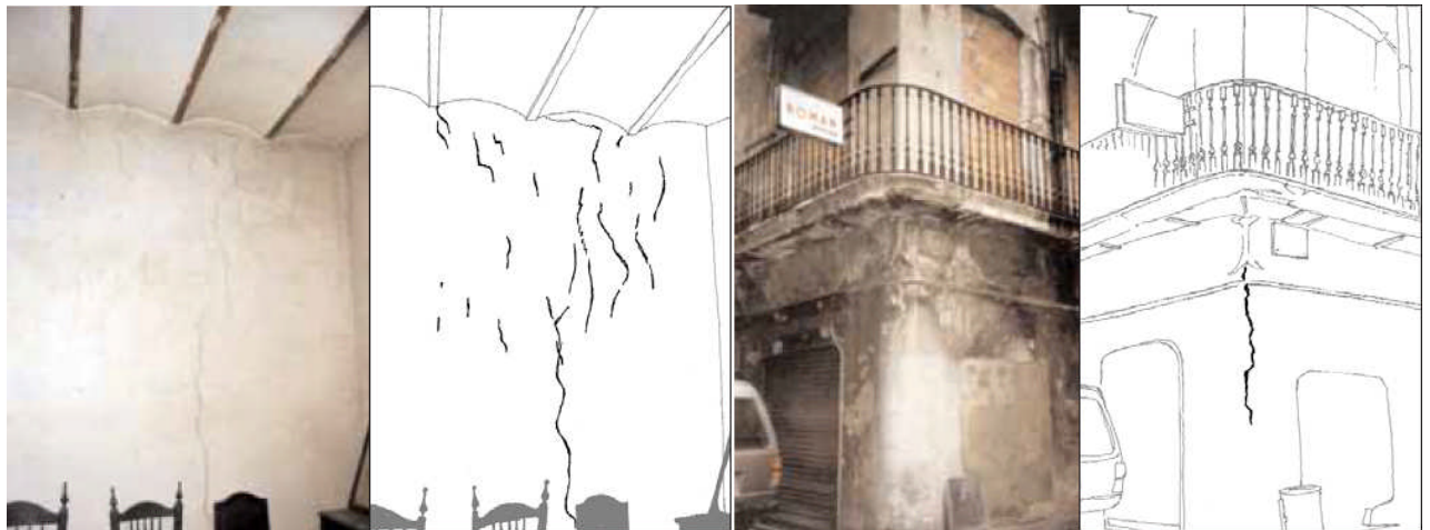
Figure 1.14 : Fissure sur les murs des maisons
