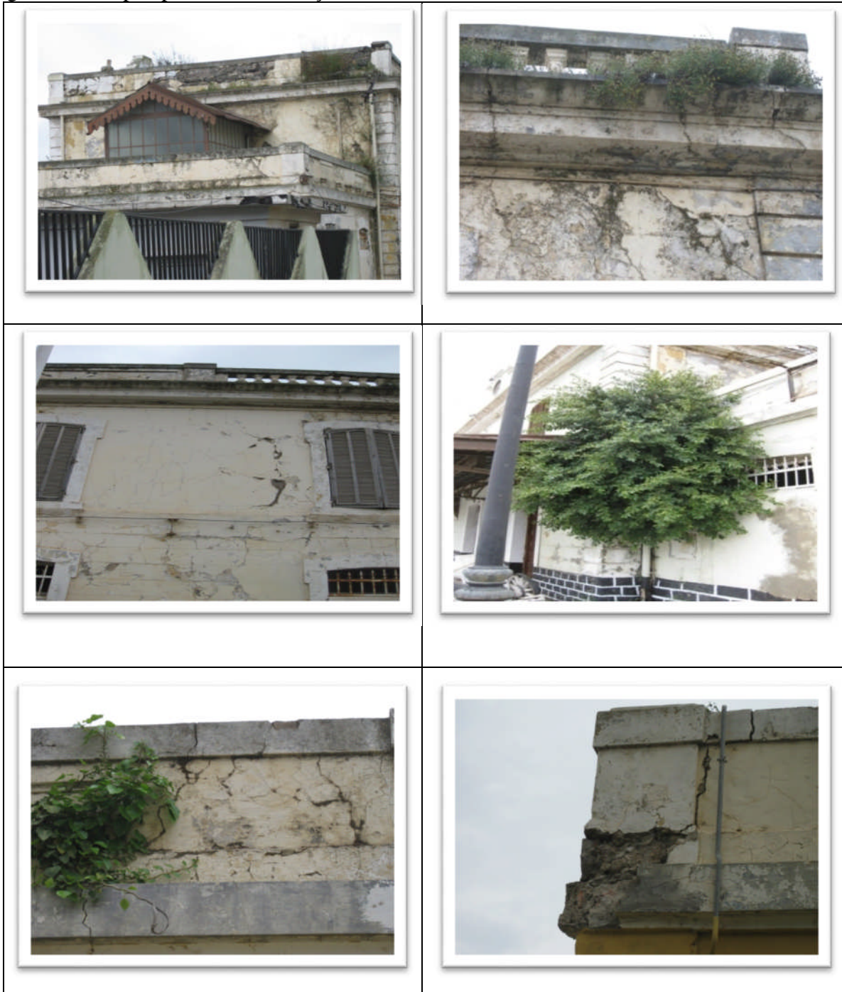
Figure 3.2 : Pathologie sur les façades
