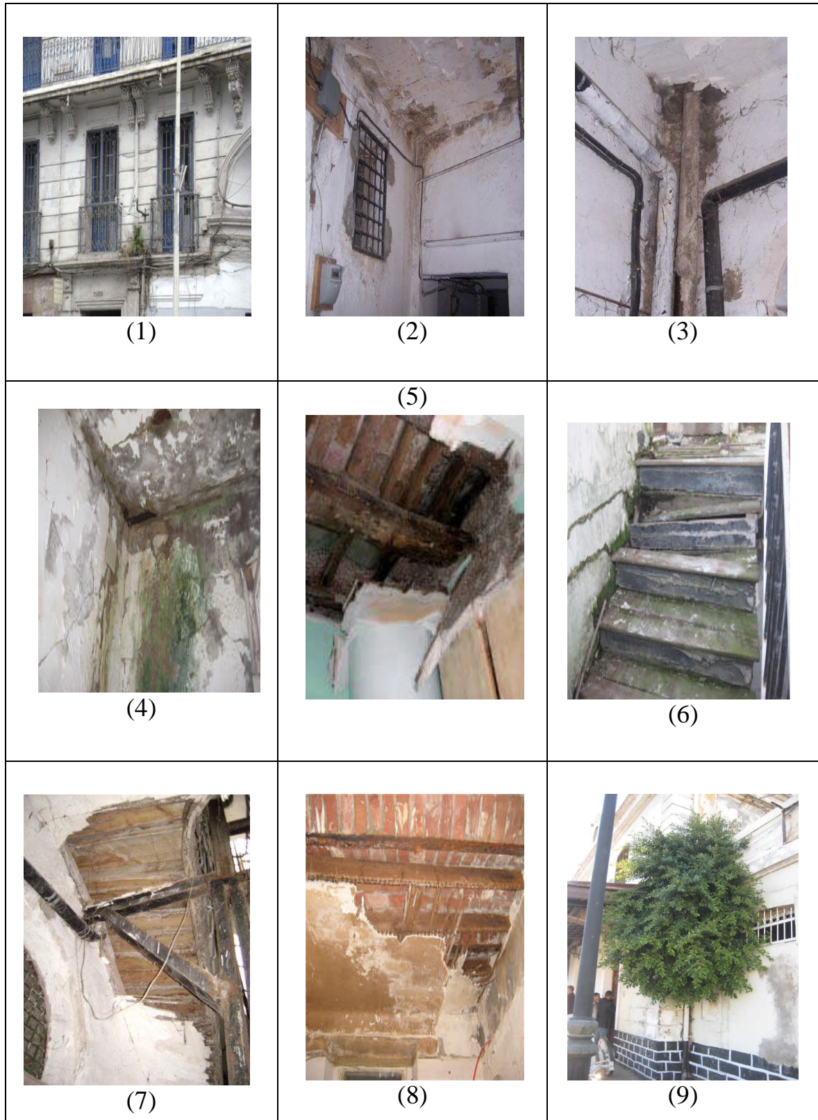
Figure 1.12 : pathologie des enceins bâtis.
