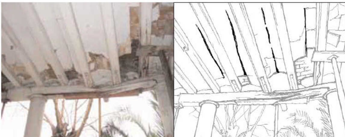
Figure 1.24 : Fissure dues a la déformation des planches
