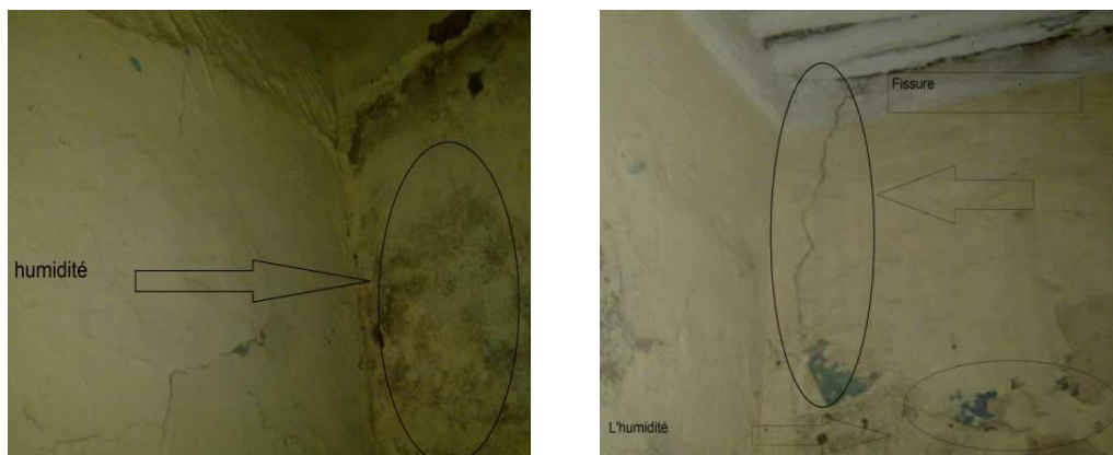
Figure 3.8 : Présence de l'humidité
