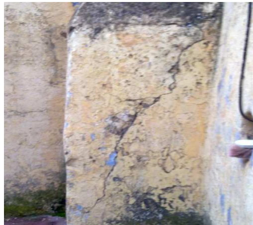
Figure 1.18 : Fissure sur un en pierre
