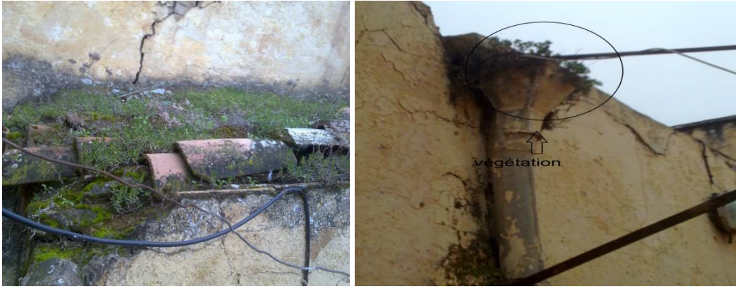
Figure 3.6 : Présence de végétations
