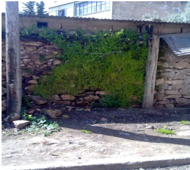
Figure 1.17 : Végétation sur un mur
