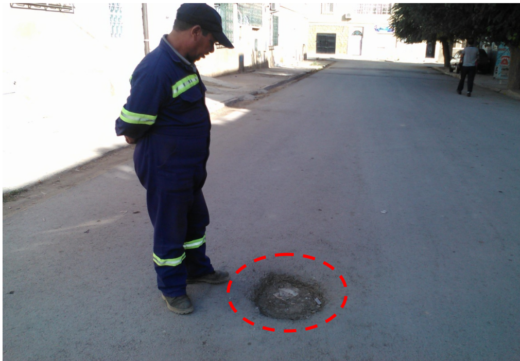
Figure III.10 : Réseau d'assainissement endommagé dans Hai Soitex.
