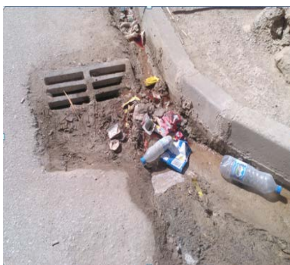
Figure III.11 : Fermeture des avaloirs dans Hai Zitoune.
