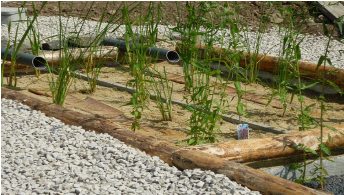
Figure III.1 : La phyto-épuration par les roseaux [W6]
