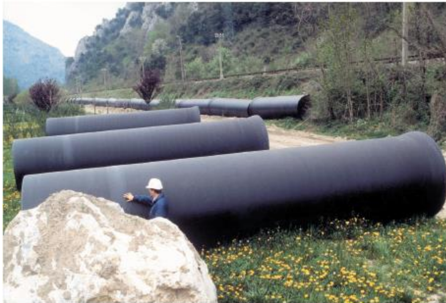
Photo I.2: Tuyaux en fonte ductile, zinc + peinture bitumineuse
