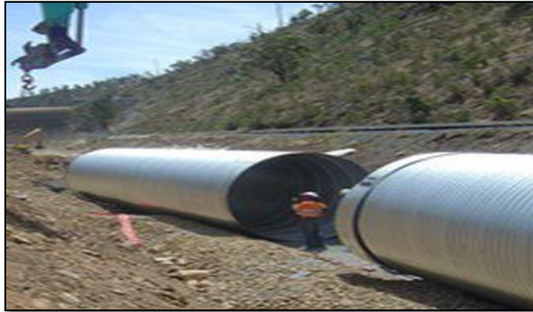
Figure I.1 : canalisation en acier (S2).
