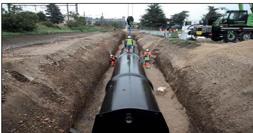
Figure I.5 : canalisation en PRV. (Godart.H, 2008).
