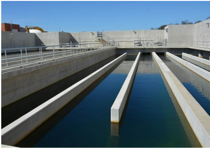
Figure I.17: Bassin de désinfection (Désinfection, 2017)
