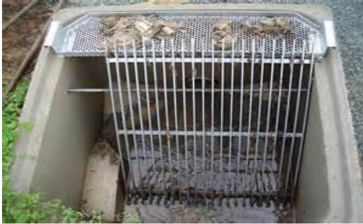
Figure I.2: dégrilleur manuelle (Module d'enseignement, 2017)
