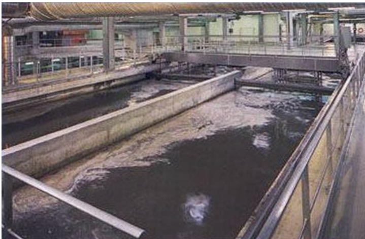
Figure I.6: Un bassin de dessablage-déshuilage rectangulaire (Module d'enseignement, 2017)
