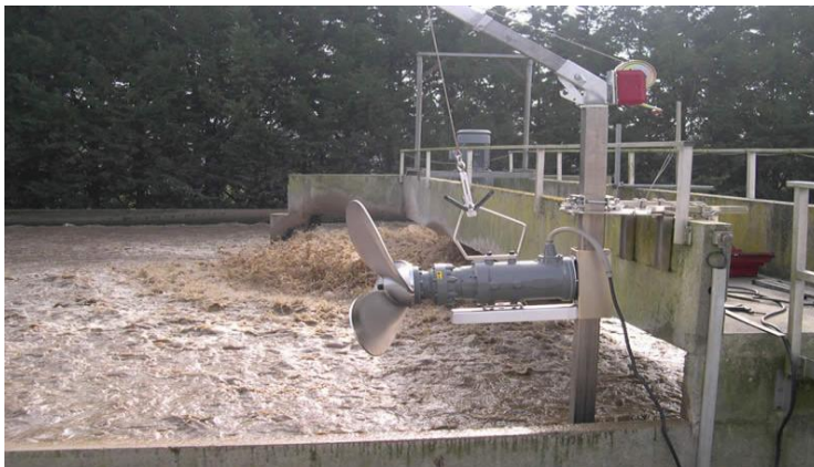
Figure I.11: Turbine d'aérateurs de surface verticale et horizontale (Agitation/aération bassin biologique , 2017)
