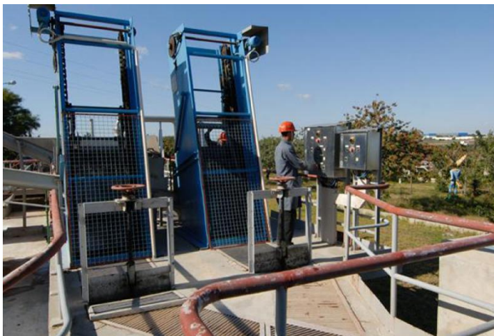
Figure I.3 : Dégrilleurs automatiques (Republique tunisienne, 2017)
