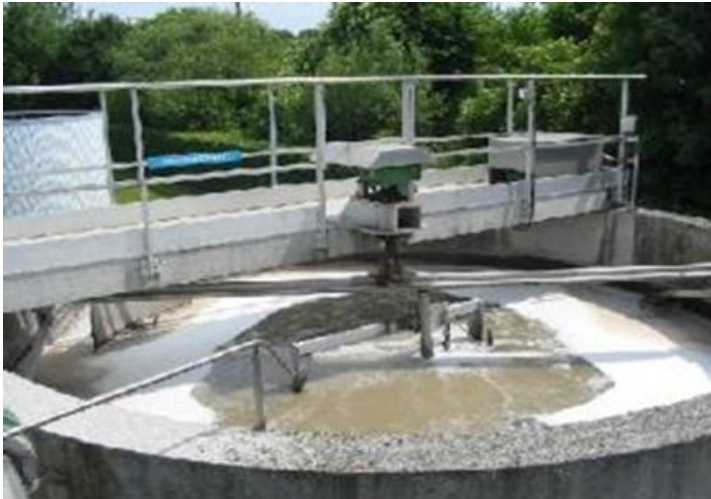
Figure I.7: Un bassin de dessablage-déshuilage circulaire (Module d'enseignement, 2017)
