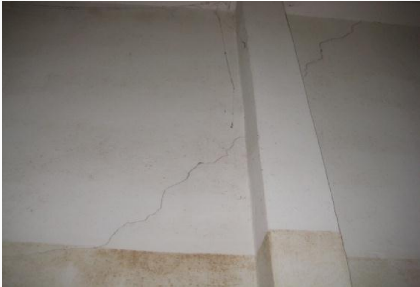
DES FISSURES DIVERSES
