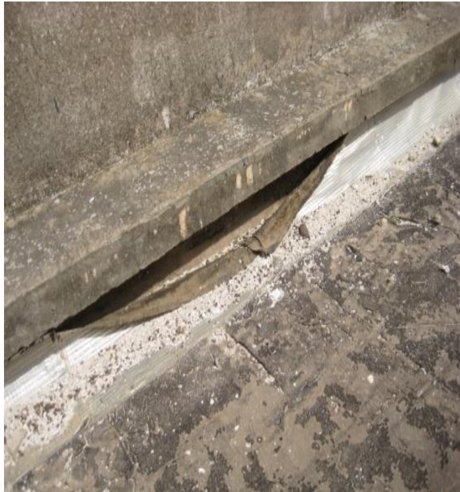
DÉGRADATION DU COMPLEXE D'ÉTANCHÉITÉ
