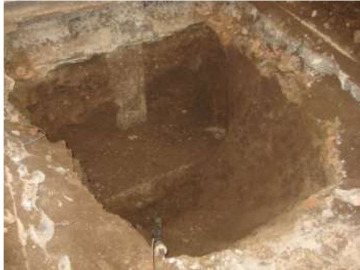
Photo 2.13. Semelle isolé encreé superficiellement.
