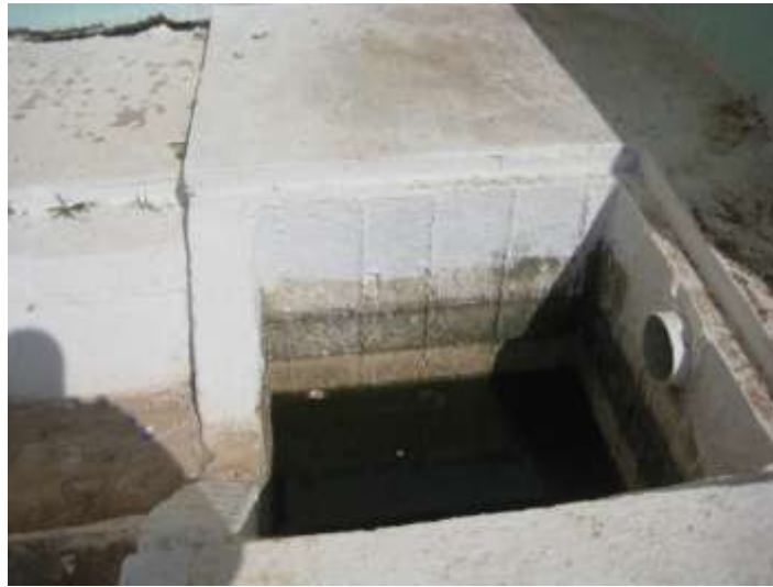
Photo 2.20. Eaux stagnantes dans le regard situé sur la périphérie du réseau de drainage.
