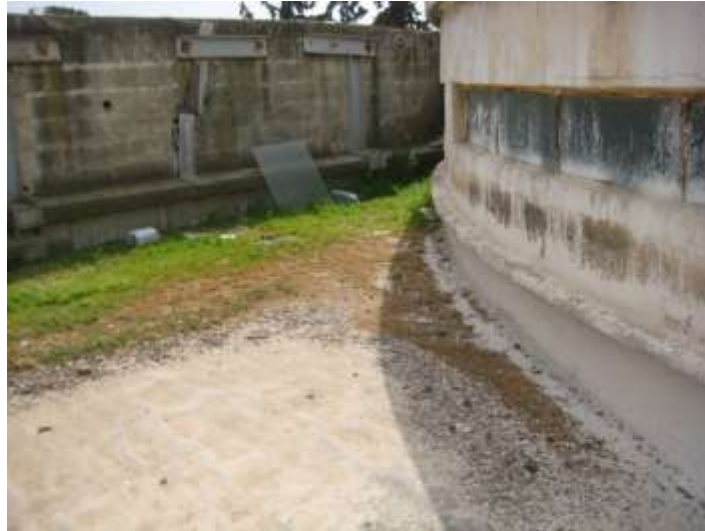
Photo 2.17. Présence de végétations sur la terrasse.
