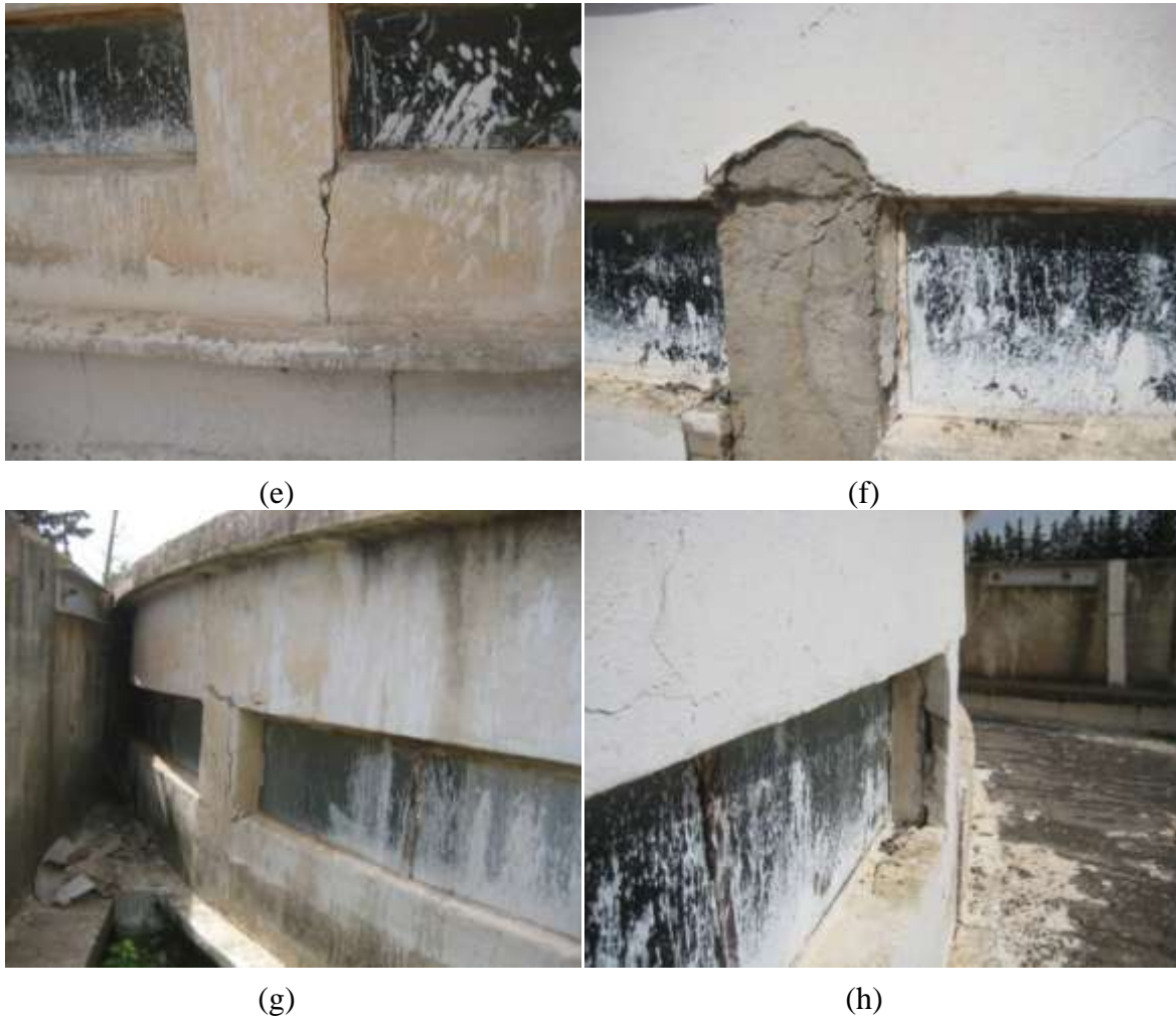
Photos 2.5. Les poteaux fissurés
