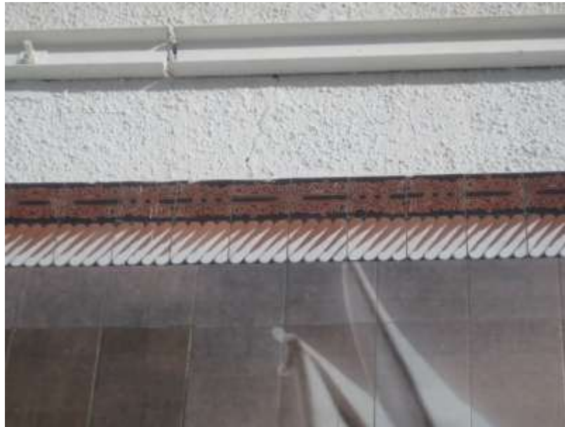
Photo 4.1. Une fissure active sur la façade de la mosquée qui est déjà réparée.
