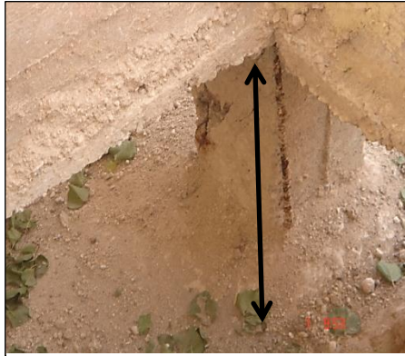
Figure.3.14. : corrosions des armatures
