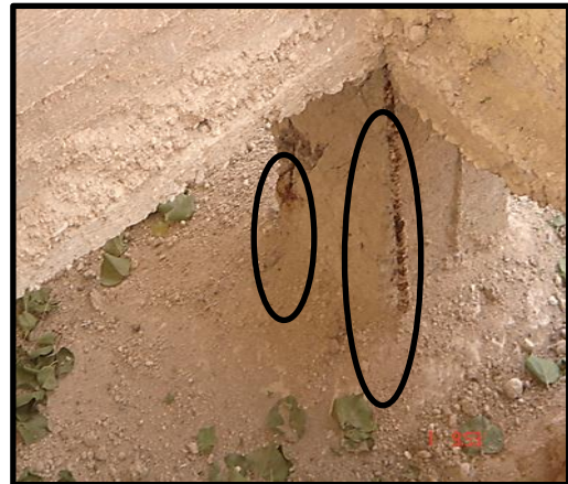
Figure 2.12. Exemple, d'armature corrodée Ibn Baytar
