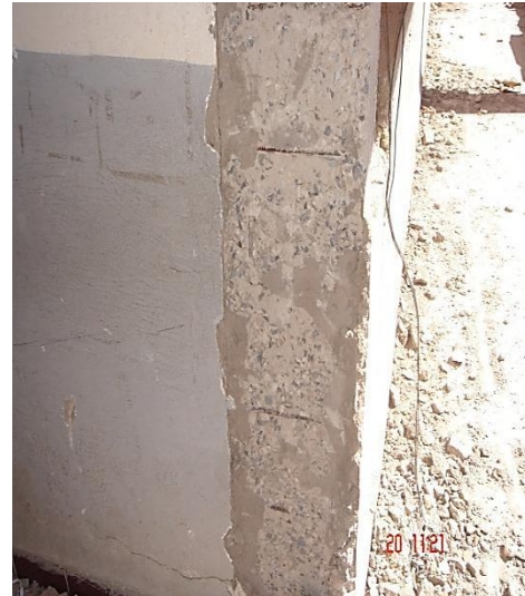
Figure 3.18. Faible l'enrobage (Ecole Ibn Baytar)
