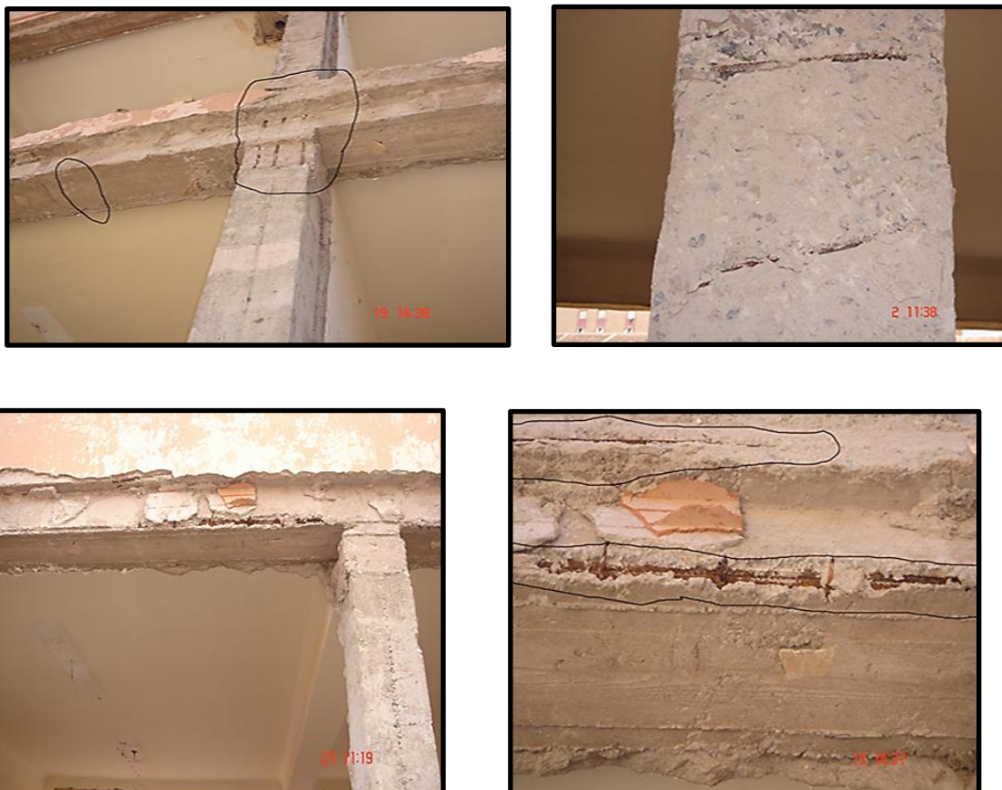
Figure 2.15. : Dégradation de l'enrobage des armatures (École Ibn Baytar)
