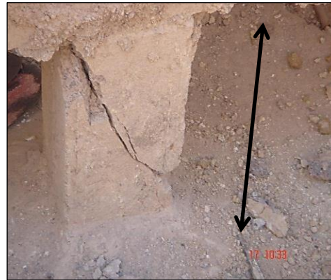
Figure 3. 15 : manque des d'armatures transversales
