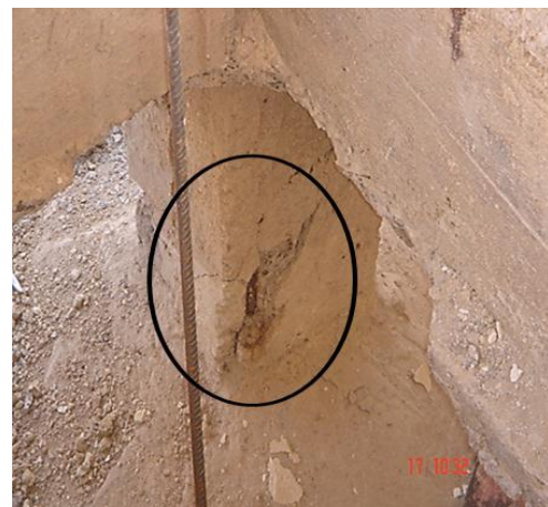
Figure 3.17 : Eclatement des bétons par phénomène de la carbonatation
