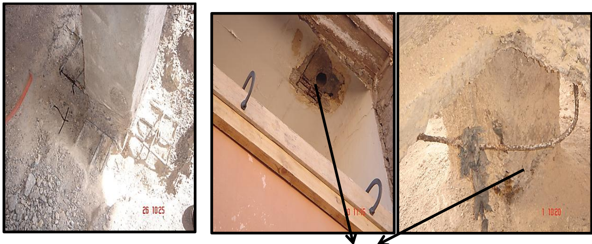
Figure 2.13. : Corrosion des armatures (École Ibn Baytar)
