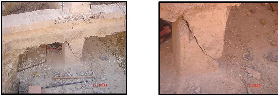
Figure 2.14: Cisaillement dans avant poteau (École Ibn Baytar)
