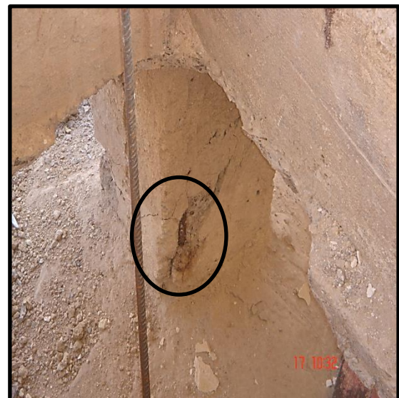
Figure 2.10. : Phénomène de carbonatation (École Ibn Baytar)
