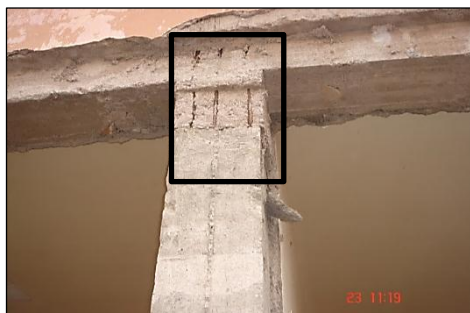
Figure 3.12. Dans les appuis Mal positionnement des armatures (Ecole Ibn Baytar)
