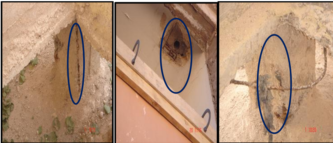
Figure 1.4 : la corrosion des armatures (école Ibn Baytar)
