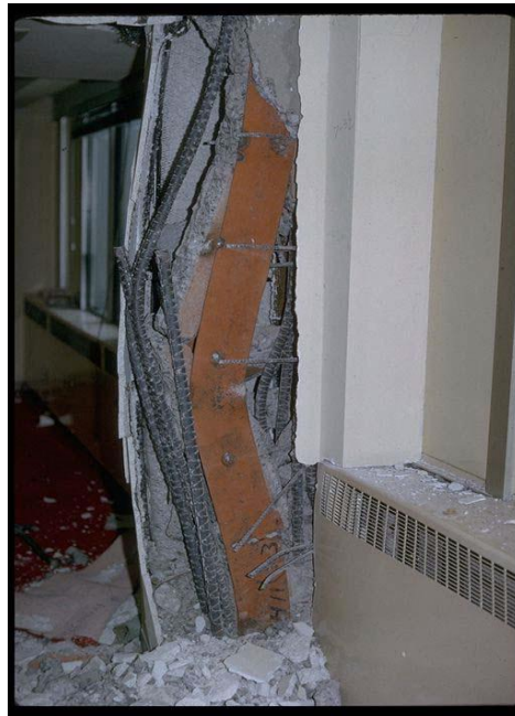
Figure II.7 : Flambement d'un poteau d'acier enrobé de BA (Séisme d'Anchorage, 1964)
