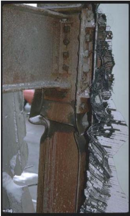
Figure II.4 : Flambement d'une tête de poteau de section en I (Séisme d'Anchorage, 1960).
