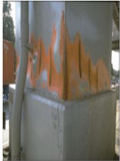
Figure II.5 : Cloquage d'un pied de poteau acier tubulaire (Séisme de Kobé, 1995)
