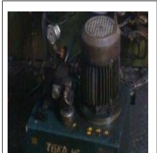
Figure 4.30 : La centrale hydraulique
