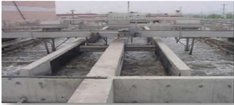
Figure III.5: bac de dessablage et dégrillage combinées
