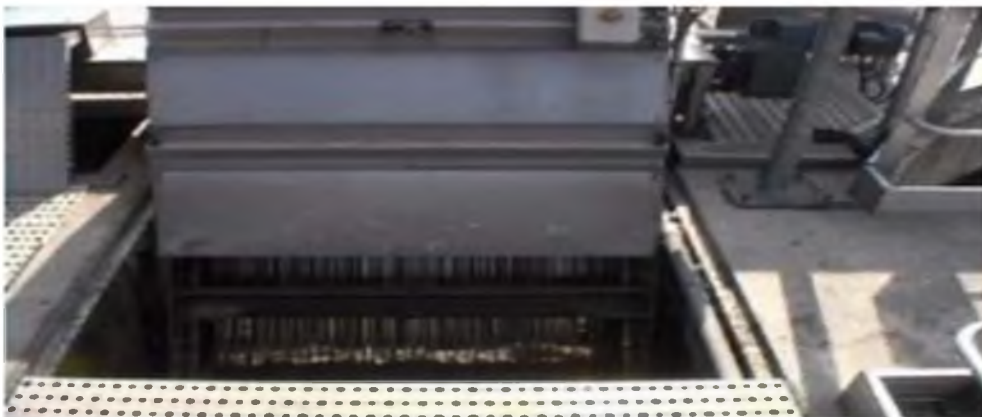
Figure III.4 : un dégrilleur fin inclus dans un tamis
