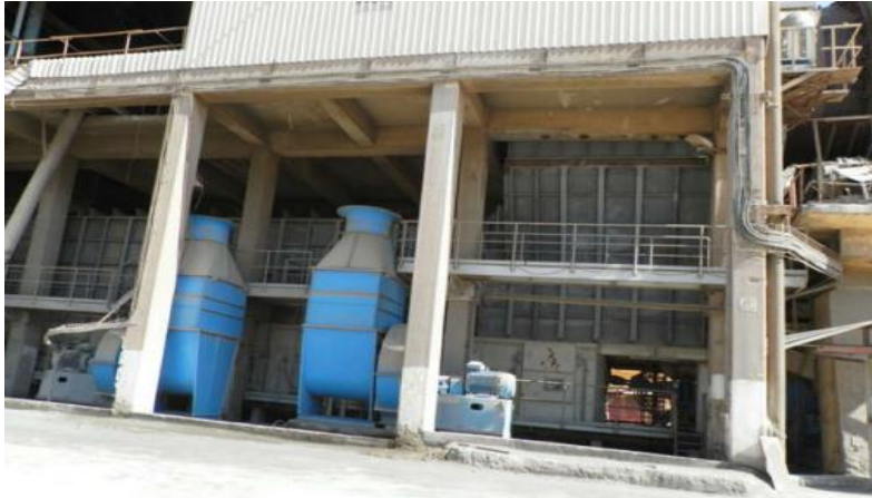
Fig.III.15 Refroidisseur ( Cimenterie de Béni Saf )
