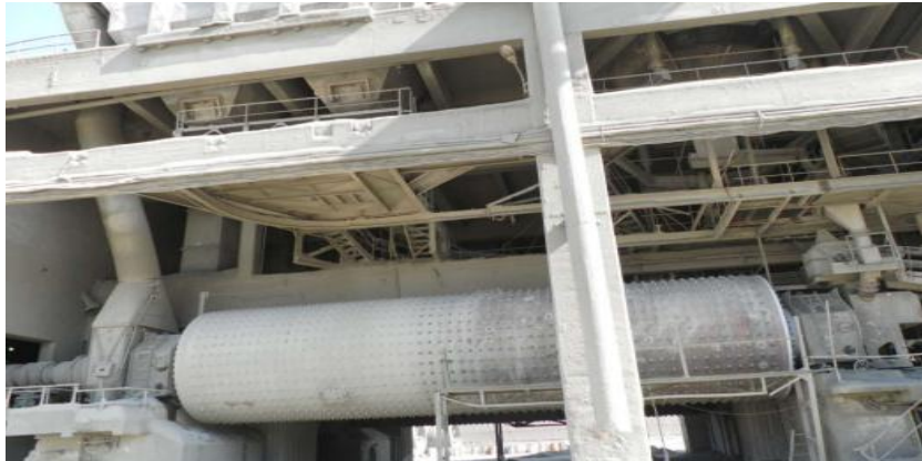
Fig.III.17. Broyeur à ciment à la cimenterie de Béni Saf
