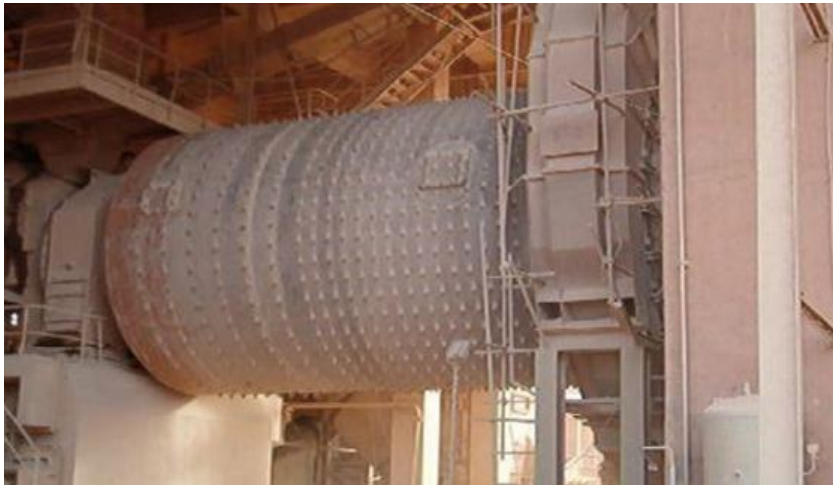
Fig. III.9. Broyage du cru (Cimenterie de Béni Saf)
