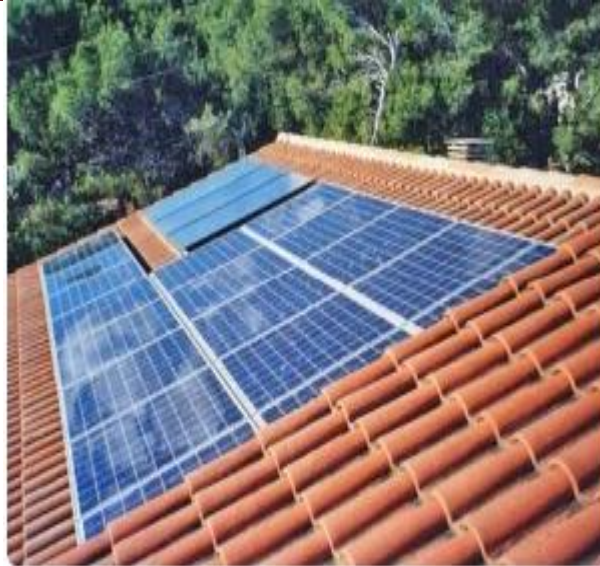
Figure (II.8): Photographie des panneaux PV.
