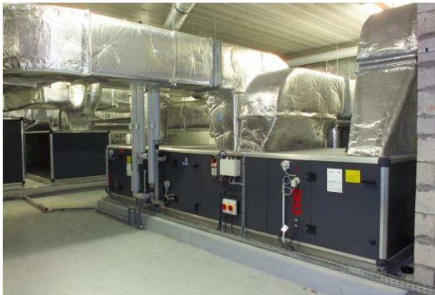
Figure IV. 4 : Centrale traitement d'air CTA.
