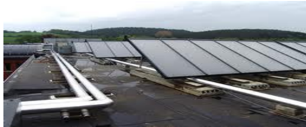
Figure I.10 : Capteurs solaires thermiques
