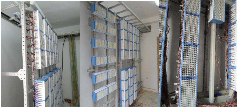
Figure III.31 : Répartiteur de MSAN
