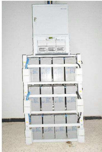
Figure III.27 : Modules redresseurs avec ces batteries
