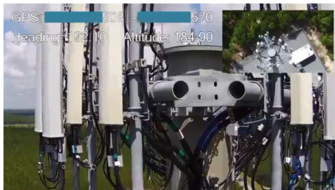
Figure 4.12: Vue sur le câblage
