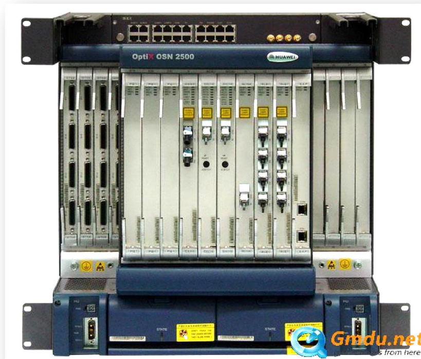
Figure III.15 : Equipement du multiplexeur SDH
