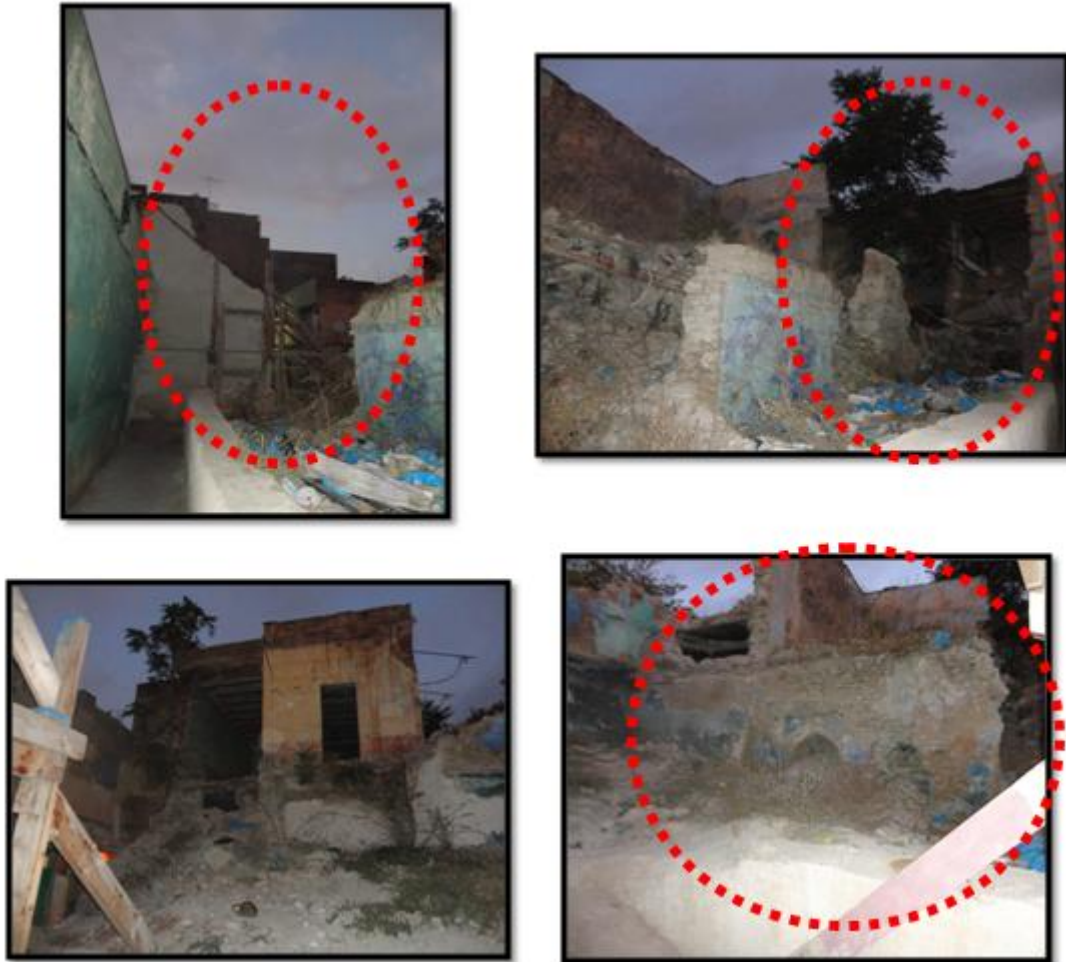
Fig.108: des maisons tombées en ruine Source: auteur -2011-
