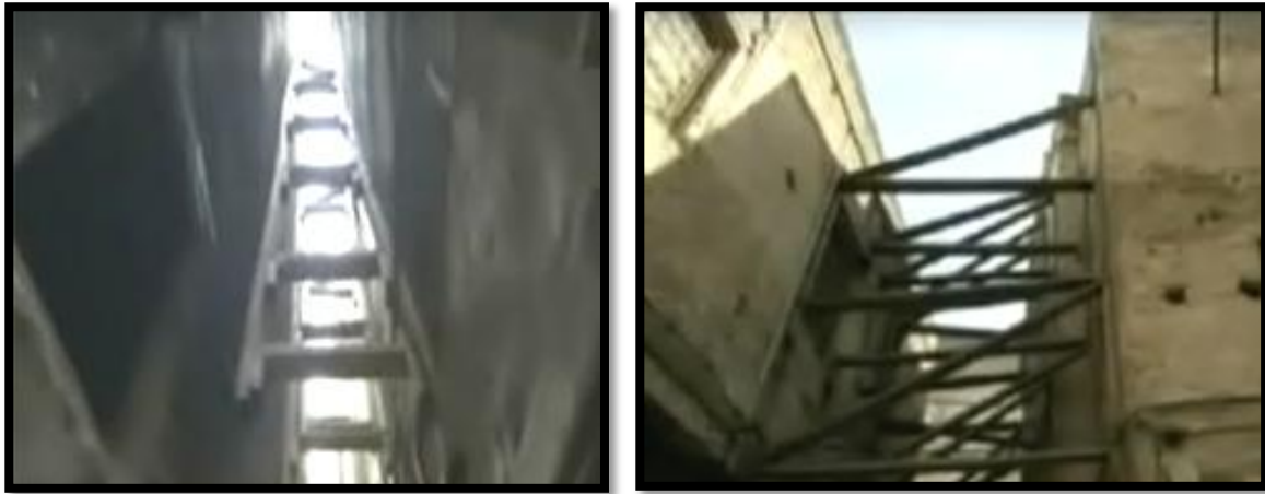
Fig.12 : des étaielements contre l'affaissement des murs Source : l'émission française: des racines et des ailes
