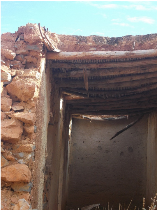
Photo 16: Habitation rurale en ruine à Taouia. (Source : Auteur, 2013)
