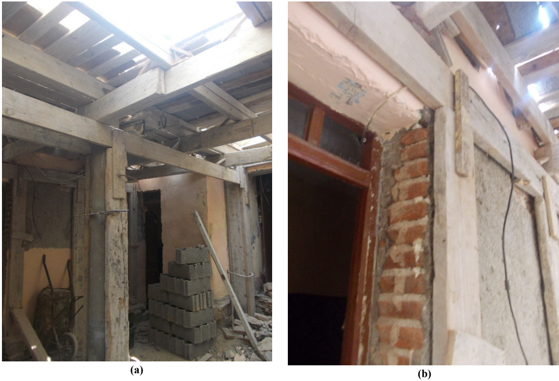
Photo 68: (a), (b), exécution des travaux de reconstruction dans une habitation traditionnelle de la médina. (Source : Auteur, 2014)
