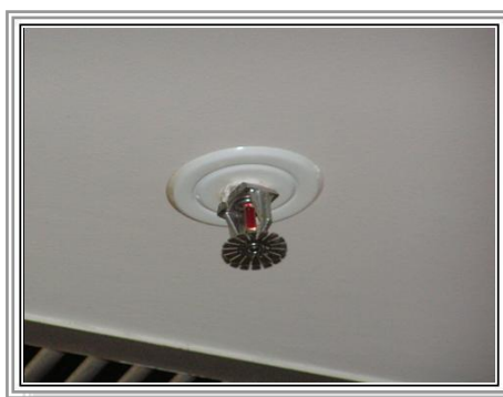
Figure 90 : vue de sprinklers
