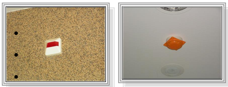
Figure 93 : Eclairage de sécurité
