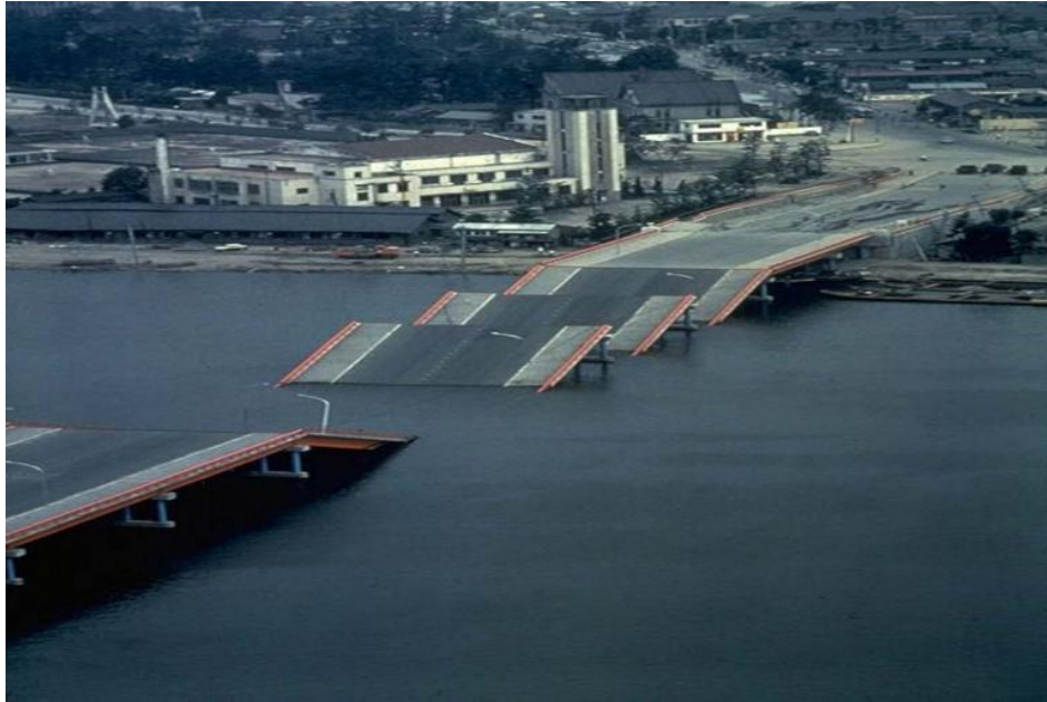
Figure 3. 4 : Rupture du pont de Showa, à Niigata au Japon, dues à l'épandage latéral dans le sol (d'après Peter M. Byrne et al, 2008).
