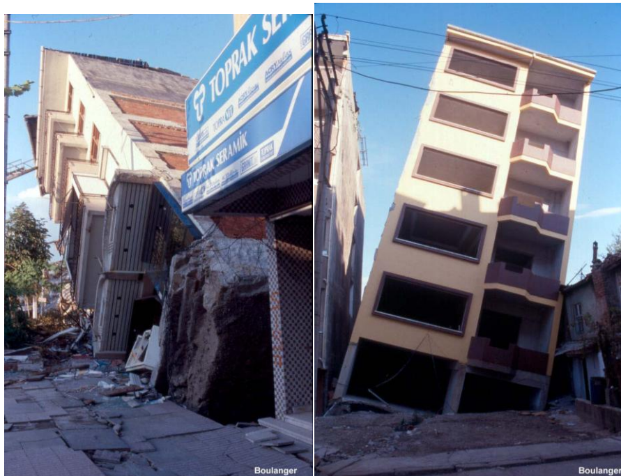
Figure 3. 5 : Dommage des édifices, Adapazani, Turki, 1999.
