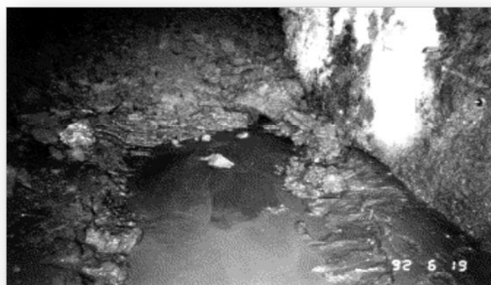
Figure 3.4 Inondation du tunnel de Wushantou, Japon, 1992. (Wang et al., 2002)
