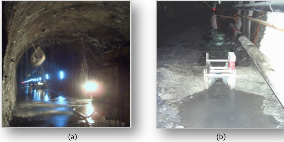
Figure 3.1 (a) Débit d'eau dans l'excavation (b) Un déversoir pour enregistrer la quantité dans l'entrée Est du tunnel (Yang et al., 2009)
