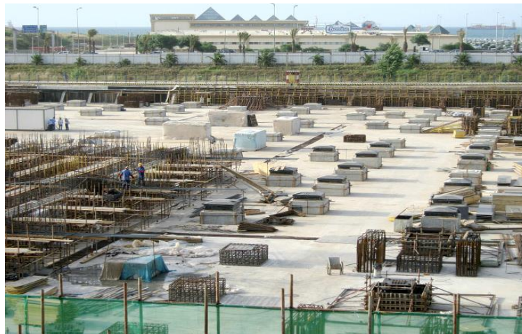
Figure 4.10 : Appuis FPS installés aux fondations de la grande mosquée d'Alger [93]
