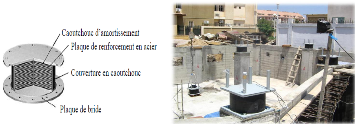
Figure 4.5 : Appuis élastomère à amortissement élevé installé au siège du CTC Chlef
