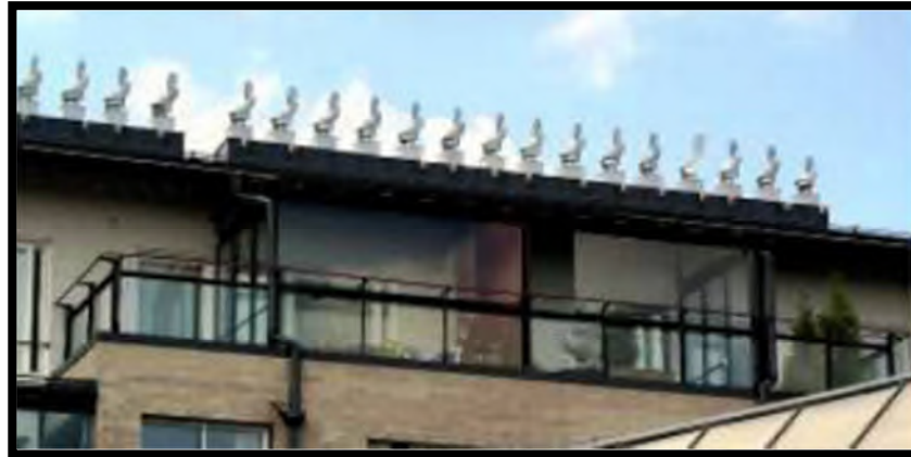
Figure 47. Système de ventilation. Source 75
