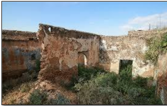
Figure 60 : une construction en ruine. (Source : auteurs)
