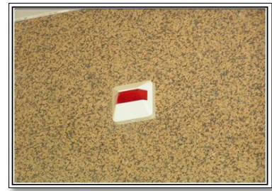
Figure 129 : éclairage de sécurité Source : mémoire « complexe autoroutier »
