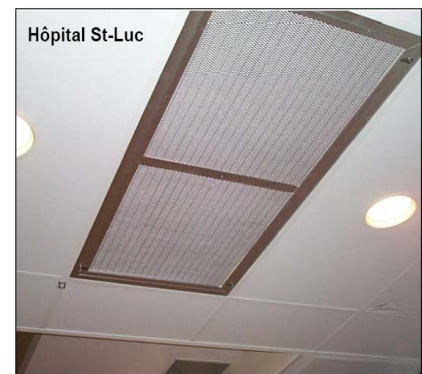
Figure 106 : les filtres HEPA dans une salle opératoire
