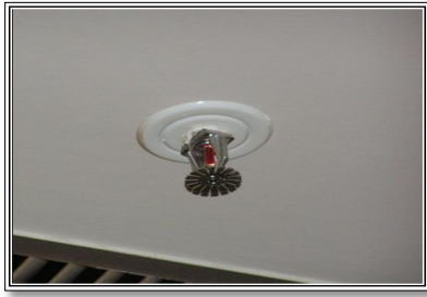
Figure 125 : sprinklers Source : mémoire « complexe autoroutier »
