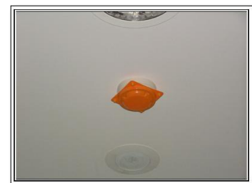
Figure 128 : éclairage de sécurité Source : mémoire « complexe autoroutier »
