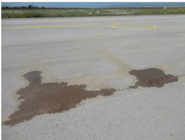
Figure 4.2 Dégradation de la piste de l'aéroport Messali El Hadj Tlemcen : Photo2
