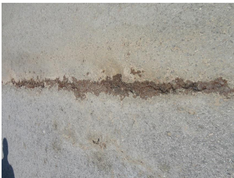
Figure 4.3 Dégradation de la piste de l'aéroport Messali El Hadj Tlemcen : Photo3
