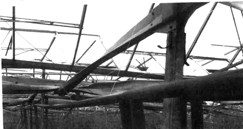
Photo I.2 : Effondrement à cause du déversement d'une poutre
