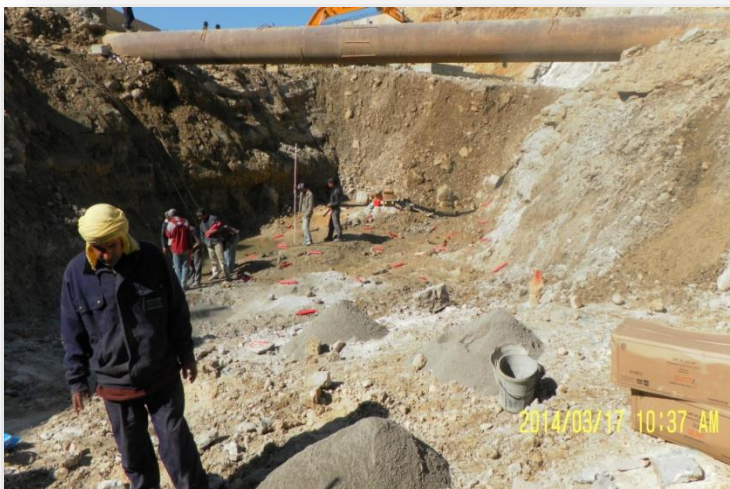
Figure 4.1. L'installation de l'explosif sur le chantier de barrage voûte mince d'oued Taht Wilaya de MASCRA.
