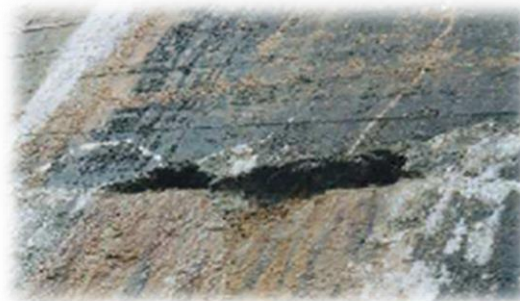
(c) Dégradation du parement aval
