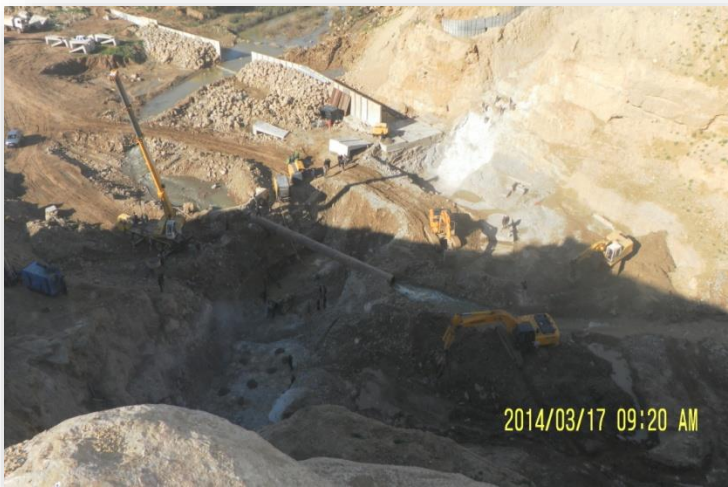
Figure 3.1. Fin des travaux d'excavation (Barrage voûte mince d'oued That Wilaya de MASCARA).
