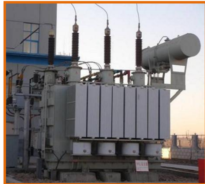
Figure 87 : Photo d'un transformateur ( http://www.ectrade.com/Auction/FreeSample/2608842530/Transformateur.html )
