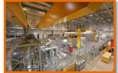
5- Salle des machines
