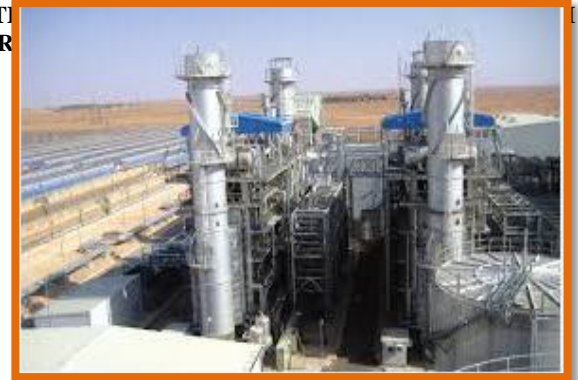
Figure 34: La centrale électrique de Hassi R'mel ( http://portail.cder.dz/spip.php?article5180 )
