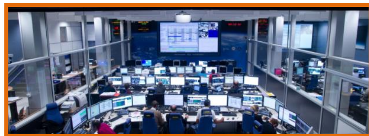
Figure 59 : Salles de contrôle
