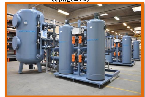
Figure 55 : Station de déminéralisation ( www.eurowater.fr/.../water_treatment_for_face_book_datacenter.aspx )
