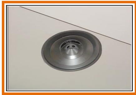
Bouches de Soufflage
