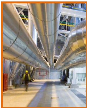
3) Salle des machines
