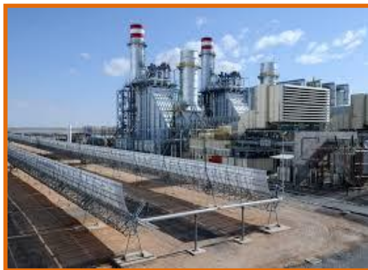
Figure 38: Vue sur la centrale de Beni Mathar ( http://www.orientalinvest.ma/centrale.php )
