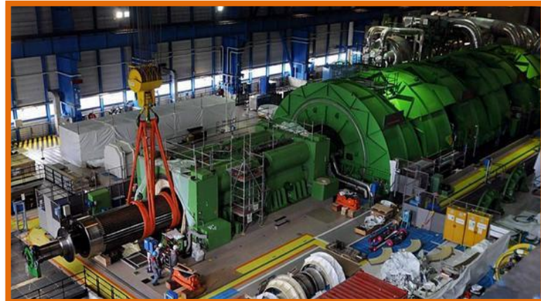
Figure 86 : photo d'un alternateur à l'intérieur d'une salle des machines. ( http://www.lanouvellerepublique.fr/Vienne/Actualite/24-Heures/n/Contenus/Articles/2013/05/31/Centrale-de-Civaux-on-change-le-rotor-d-un-alternateur-1487258 )
