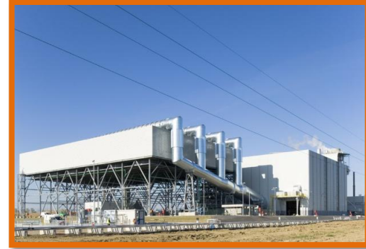
Figure 53 : Les aérocondenseurs ( www.cyrilledubreuil.com/construction/energi )
