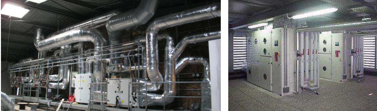
Figure 157 : Installation de ventilation Source : http://static3.seety.pagesjaunes.fr/dam_9601483
