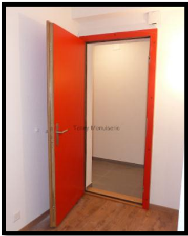
Photo60 : exemple d'une porte coupe-feu
