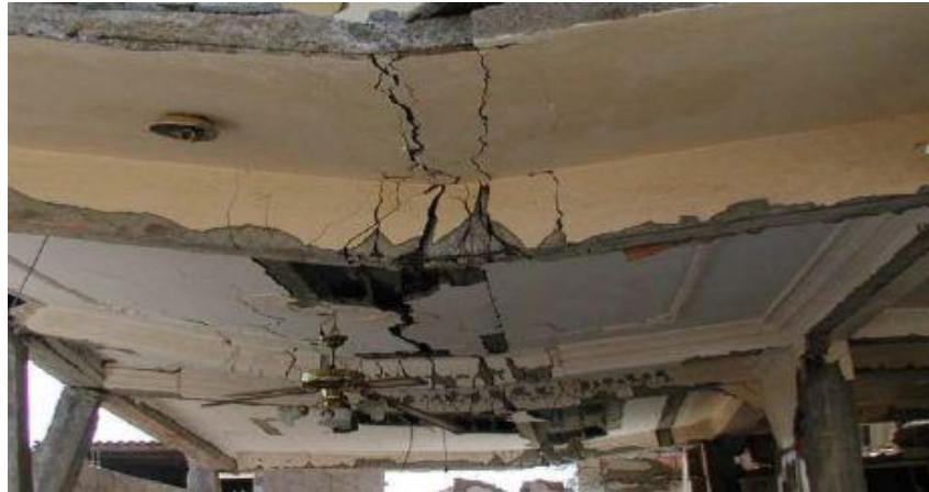
Figure1.5- Endommagement d'une poutre par flexion
