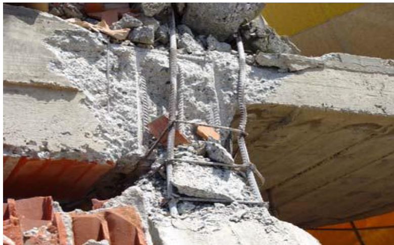
Figure1.4- Endommagement d'un nœud a raison de l'insuffisance des armatures transversales(Boumerdes, 2003) [6].
