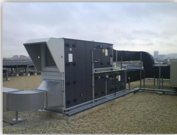
Figure 103. Photo d'une centrale de climatisation de l'aéroport Mérignac (Bordeaux, France)
