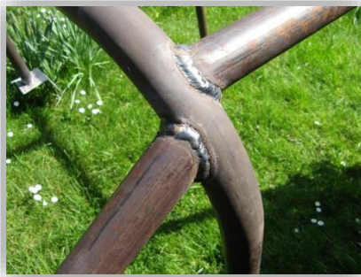
Figure 98. Photo de l'intersection en gueule loup d'éléments métalliques
