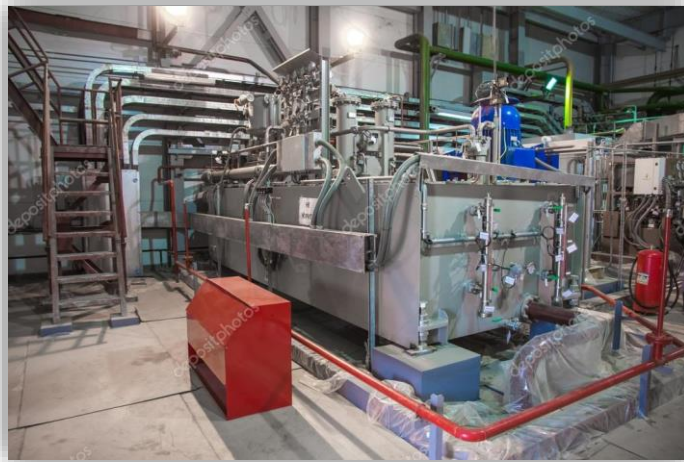
Figure 104. Photo d'une centrale électrique de l'aéroport Costa Del Sol (Malaga, Espagne)
