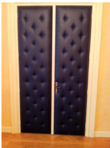
Figure 210 : exemple de porte acoustique
