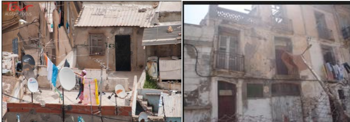
Figure 9 : dégradation du cadre bâti au centre historique de sidi el houari à Oran
