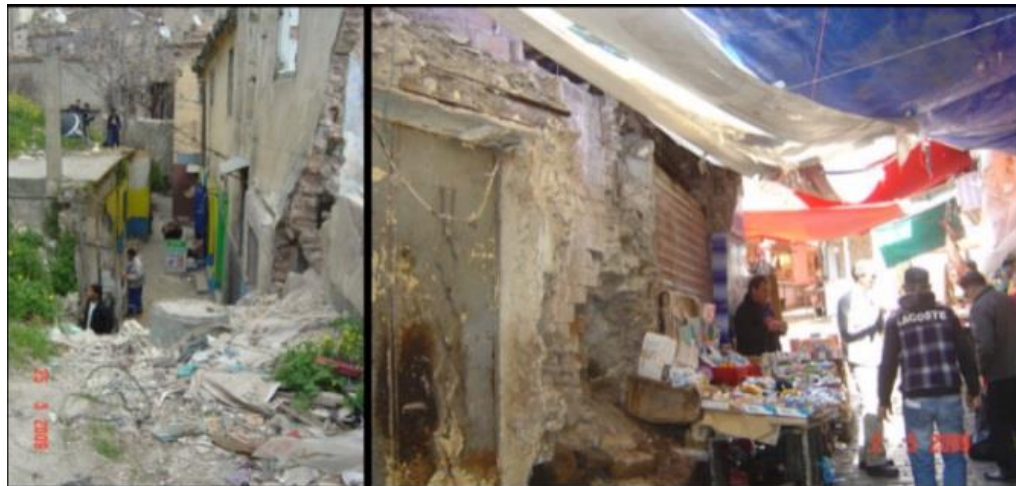
Figure 10 : Des constructions tombent en ruine avec l'apparition du commerce informel à quartier souika en Constantine
