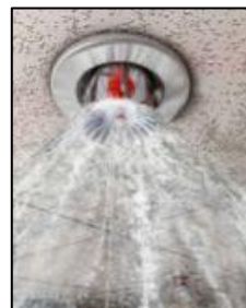
Fig111. les extincteurs automatiques
