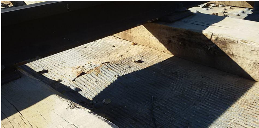
Photo.4.13 Tôle striée déformée du tablier
