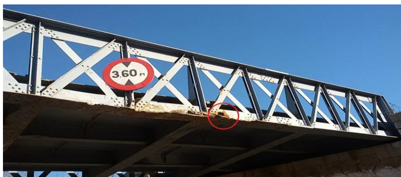
Photo.4.10 Poutre principale vers Sebdu où la déchirure est visible.
