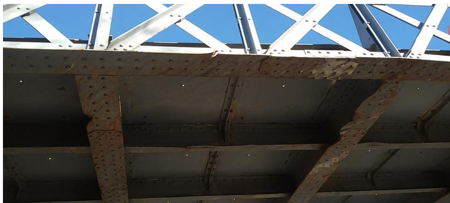
Photo.4.15 Poutrelles 03 et 04 en allant vers la gauche du coté de Sebdu
