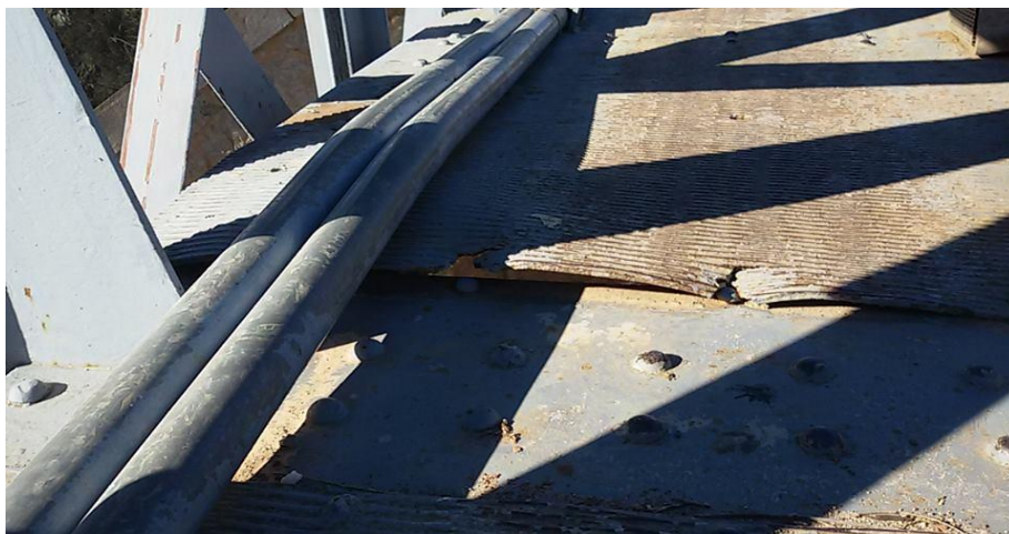
Photo.4.14 Tôle striée arrachée et tuyaux déformés
