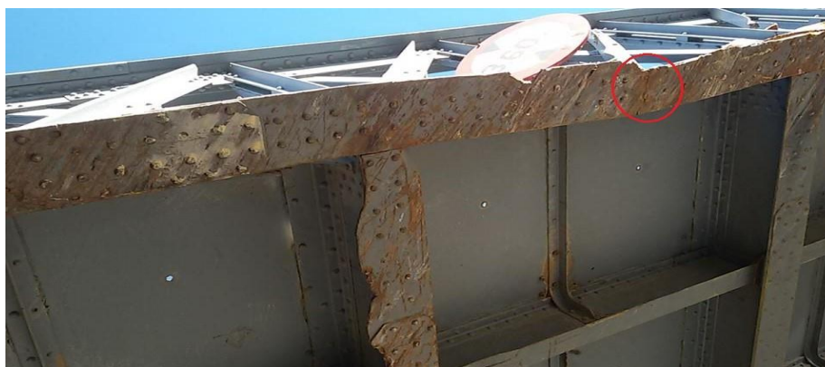
Photo.4.5 Semelle inférieure de la poutre principale vers Sebdou (partie fissurée), côté sud.
