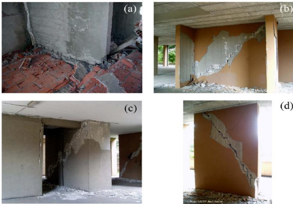
Figure1. 1: Dommages subis par les voiles (a) Rupture de section à la base du voile (Séisme de Boumerdes du 21/05/2003) ; (c) endommagement aux niveaux de nœud poteaux forte poutre faible. (b-d) : Rupture en cisaillement des voiles (Séisme de L'Aquila 06/04/2009).
