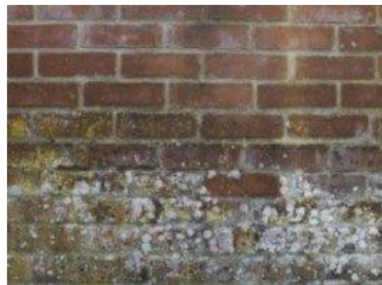
Figure 1.15: Moisissure sur un mur extérieur [ www.leroymerlin.fr ]
