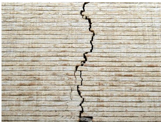
Figure 1.14: Fissure en coup de sabre [ www.securiteinterieure.fr ]
