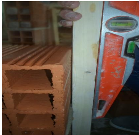
Figure 3.26: Vérifier la planéité et la verticalité entre les deux lignes horizontales par le biais d'une règle et du niveau à bulle.
