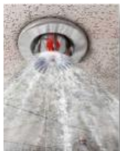
Figure 31. Un extincteur automatique
