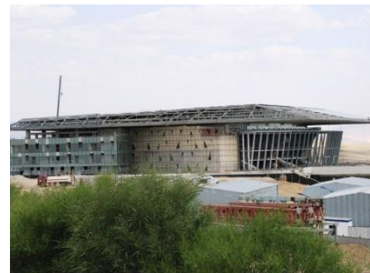
Figure 12. l'état réel de la structure
