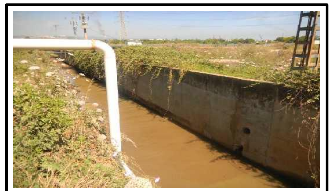
Figure 94 : Rejet 2 du canal de rejets du complexe de Raffinage du Pétrole (RAF)
