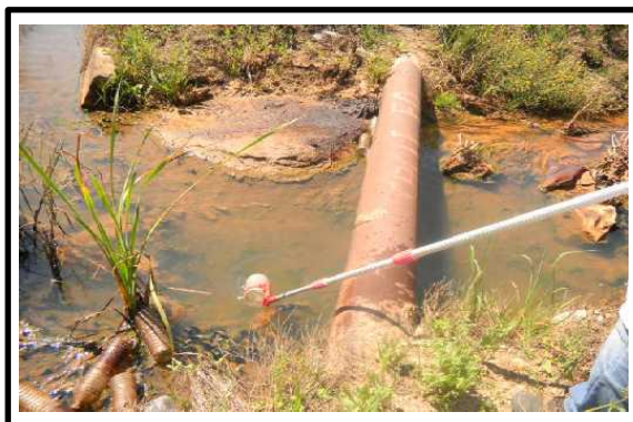
Figure 93: Rejet 1 du canal de rejet de la du complexe de transport et de stockage des hydrocarbures(RTE).
