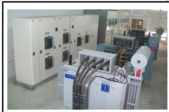
Figure 140: poste transformateur (Source: www. Poste transformateur.com )
